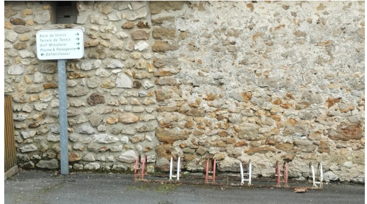
Racks vieillissants à Luché Pringé
